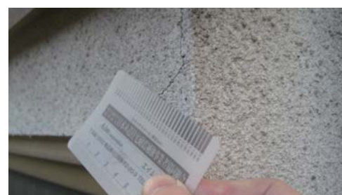
外壁のひび割れを計測しています。 多くの家屋で見られます。
